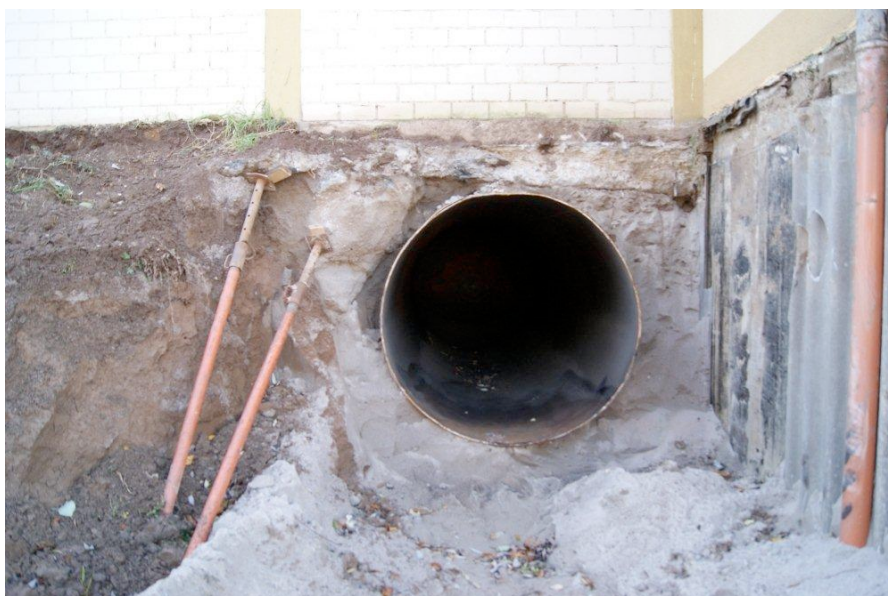
Stabilitätsproblem: Das Fundament mußte stückweise unterfangen werden um die Stabilität der Bootshalle gewährleisten
